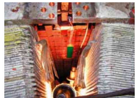
Abbildung 3 Installation des Sensors für den Luftspalt (grüne Platte) und des Sensors für den magnetischen Fluss rechts neben dem Luftspaltsensor zwischen zwei Polen an den Ständerblechen.
