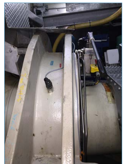
Abb. 1: Einer der Beschleunigungssensoren am Hauptlager einer Windturbinen im Lone-Star-Windpark in Texas, USA.
