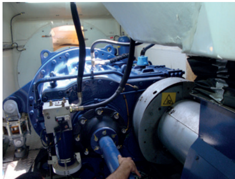
Abb. 1: Standortbegehung im Rahmen der Installation der Überwachungs- und Sensorhardware an unterschiedlichen Turbinentypen (links: Gamesa Typ 1, rechts: Gamesa Typ 2).
