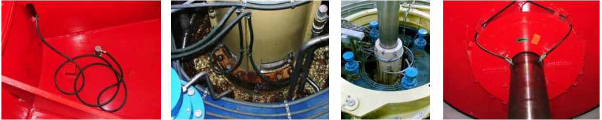
Abbildung 4 Beispiele für die Installation der Sensoren in Wasserkraftgeneratoren Ganz links ist auf der Generatorabdeckung ein Geschwindigkeitssensor zur Überwachung der axialen Vibrationen angebracht. Die beiden Fotos in der Mitte zeigen einen radialen X-Y-Wegsensor, der knapp über dem Führungslager der Turbine montiert ist. Ganz rechts sieht man radiale X-Y-Wegsensoren, die unterhalb des unteren Führungslagers des Generators montiert sind.
