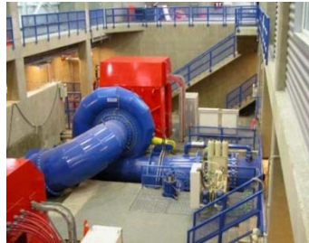
Abbildung 2 Typischer kompakter Wasserkraftgenerator von Andritz Hydro (horizontale Francisturbine, 9,2 MW).
